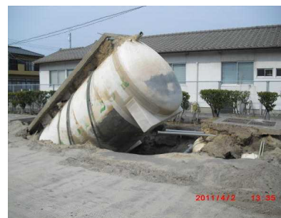
液状化で地中から表れた浄化槽
