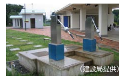
災害対応トイレ （建設局提供）
