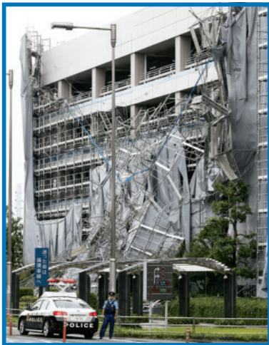
台風の強風によって、東京国際空港(羽田空港)内の工事現場の足場が倒壊した[令和元(2019)年9月の台風第15号](共同通信社提供)
